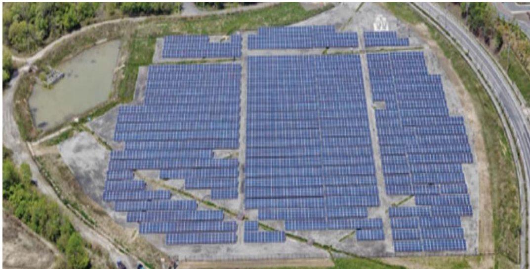
豊田工場 太陽光発電設備
